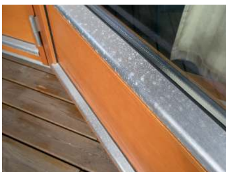
Afbeelding 1 Corrosiepokken op aluminium glaslatten toegepast in de buurt van de kust.
