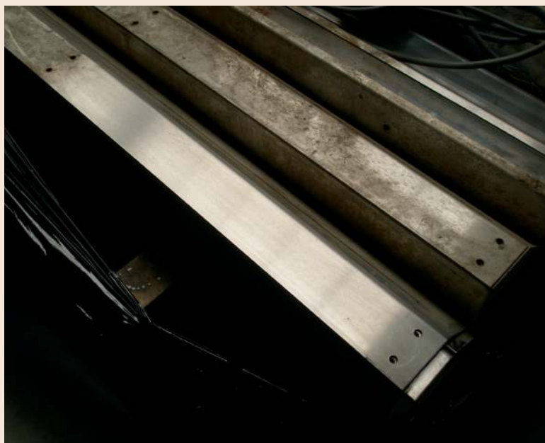
Afbeelding 4 Besmettingscorrosie op lichtarmaturen van 316L (het onderste armatuur is gedeeltelijk behandeld met het organische zuur Innosoft B570).
