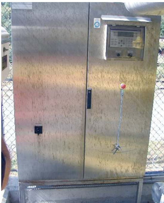
Afbeelding 3: schakelkast van roestvast staal AISI316 in de buurt van de kust na 2 jaar gebruik.
