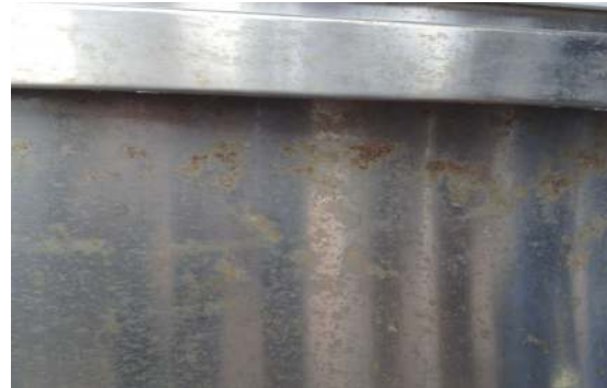
Afbeelding 4: RVS316 gevel materiaal dat extra is aangetast in het 'droge gebied'.
