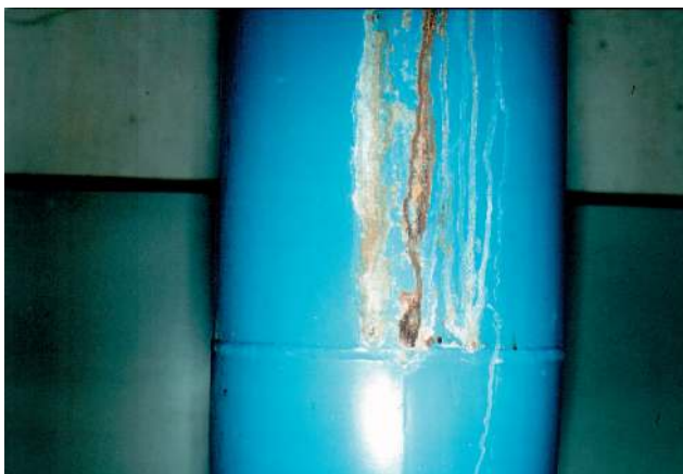
Afbeelding 3 Een gecorrodeerde hoofdleiding van AISI 304L in een waterwinbedrijf dat na 1 jaar lek was vanwege het niet backen.
