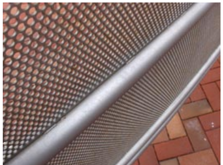
Afbeelding 7 Alle roest tussen de plaat en buizen is verdwenen.
