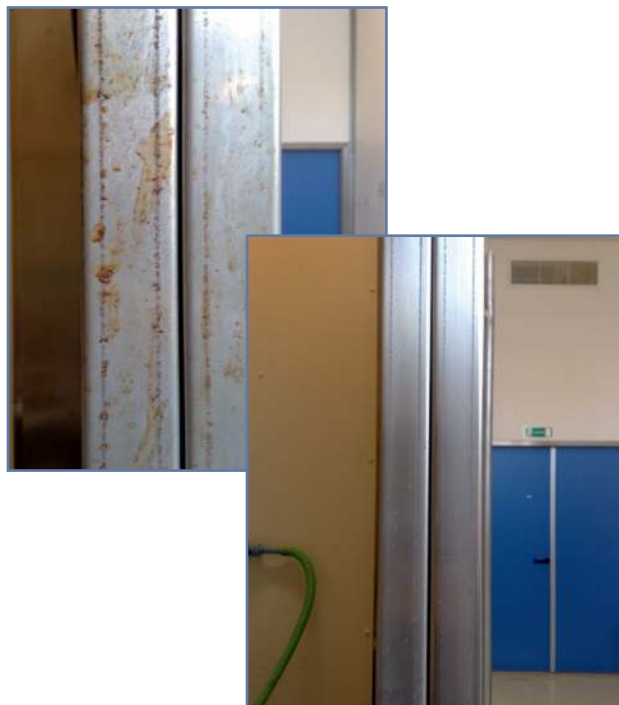
Afbeelding 5 RVS-deurstijl door zoutzuurdampen aangetast.
