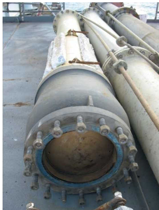
Afbeelding 6. Stijgbuizen van duplex roestvast staal 1.4462 voorzien van conventionele anodes.
