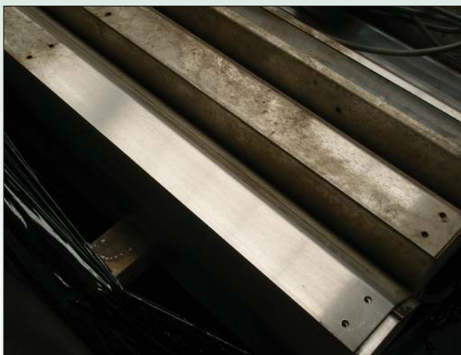
Figuur 4. Besmettingscorrosie op lichtarmaturen van 316L. Het onderste armatuur is gedeeltelijk behandeld met de organische reiniger.
