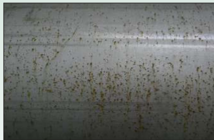
Figuur 1. Besmettingscorrosie op roestvaststalen buizen veroorzaakt door het slijpen van koolstofstaal.
