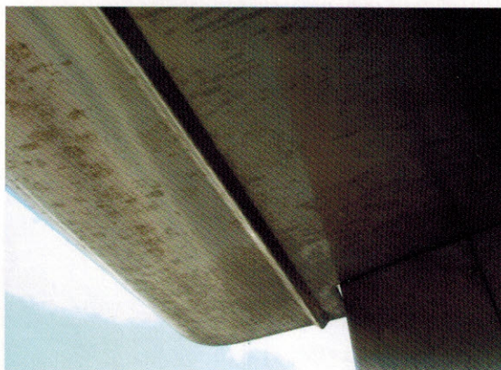
Afbeelding 4. Gevelelement van roestvast staal dat niet gereinigd kon worden door regelmatige regenbuien.
