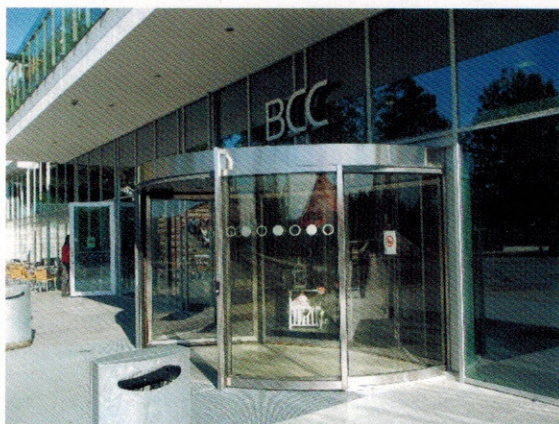
Afbeelding 2. Een roestvast stalen draaideur die ogenschijnlijk vrij van roest is.
