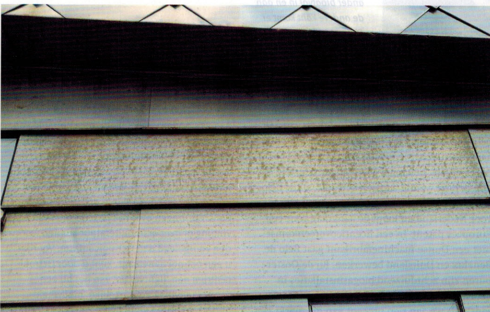
De roestvast staal gevel van een gemeentehuis begon na dik een jaar al te roesten en vooral op die plekken waar de regen niet bij kon. Dit had met een goed onderhoudsplan voorkomen kunnen worden.
