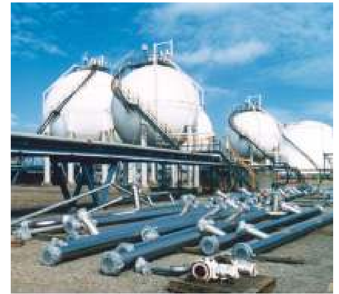
Titaan grade 2-buizen t.b.v. chemisch riool VC plant.
